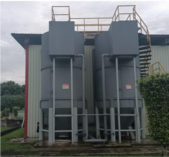
重力浓缩罐现场图
