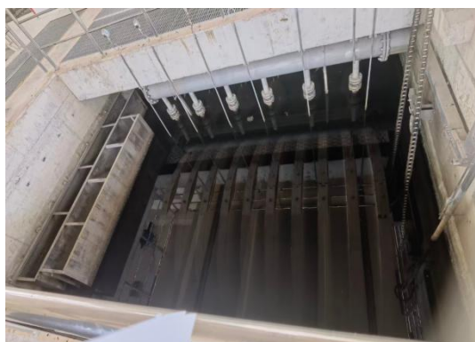
沙塘二期滤布滤池现场图（停运状态）
