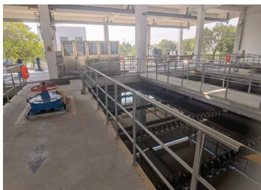
沙塘二期磁混凝高效池现场图
