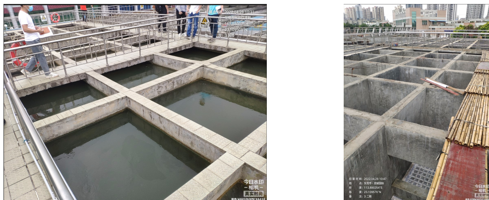
图 8-10 黄洲水厂网格絮凝池
