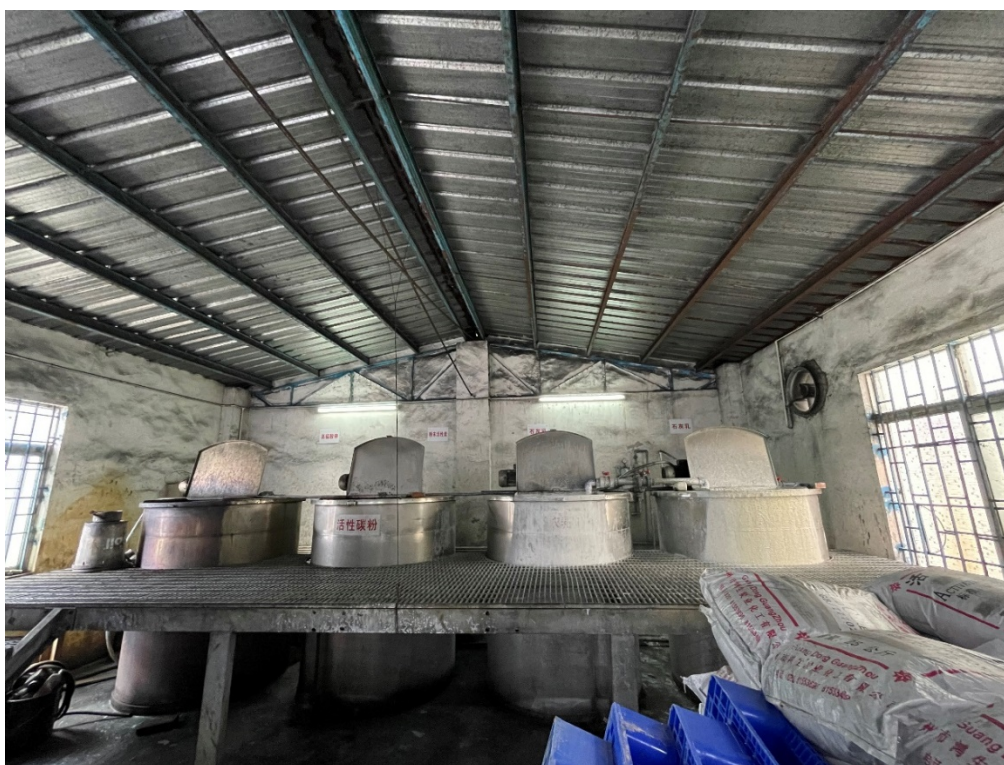
图 8-5 石碣水厂现况加药间
