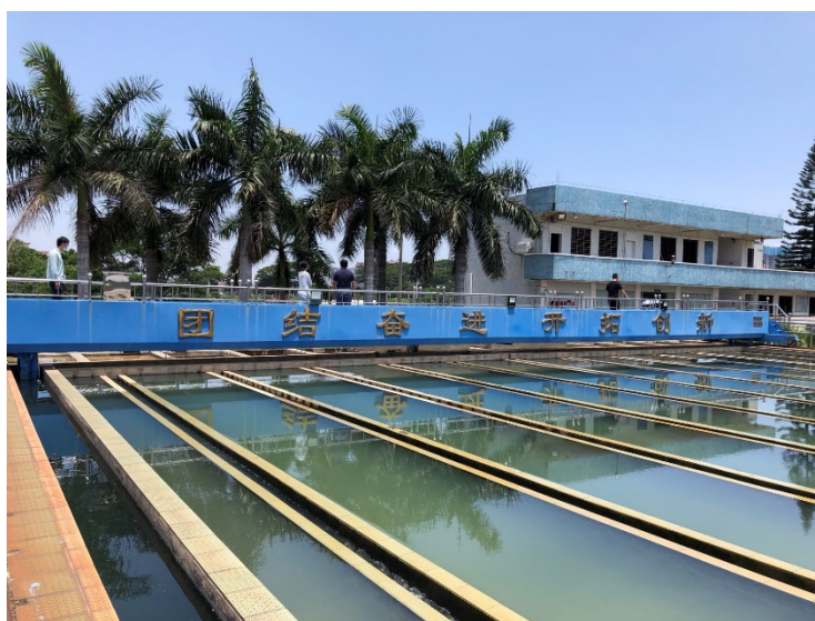
图 8-13 二期斜管沉淀池
